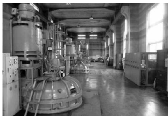
図13 旧松重ポンプ所の内観
