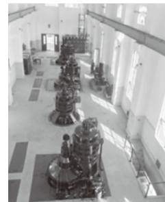
松重ポンプ所の内部
