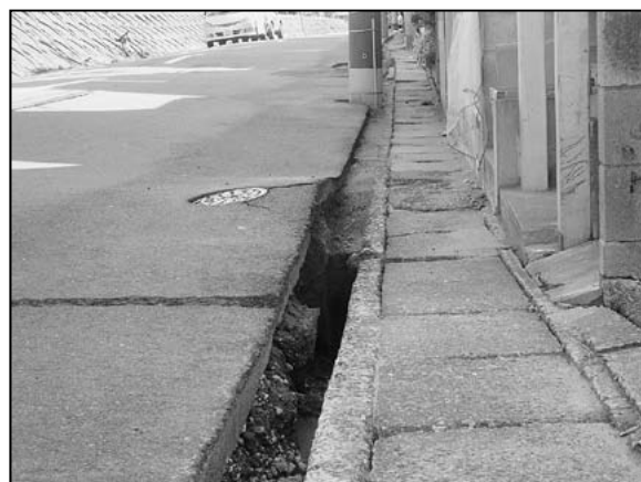
写真－8 液状化現象による道路の被害状況
