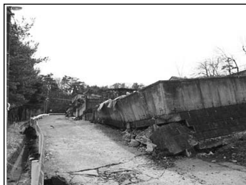
写真-4 盛土造成地での宅地被害状況
