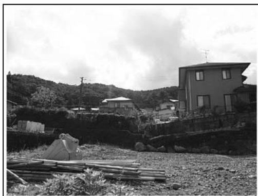
写真-3 盛土造成地での宅地被害状況
