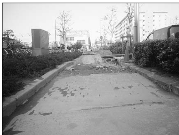
写真－7 液状化現象による道路の被害状況
