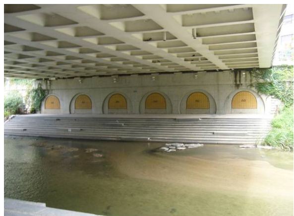
洪水時の放水のための水門。目立たないように橋の下に設置
