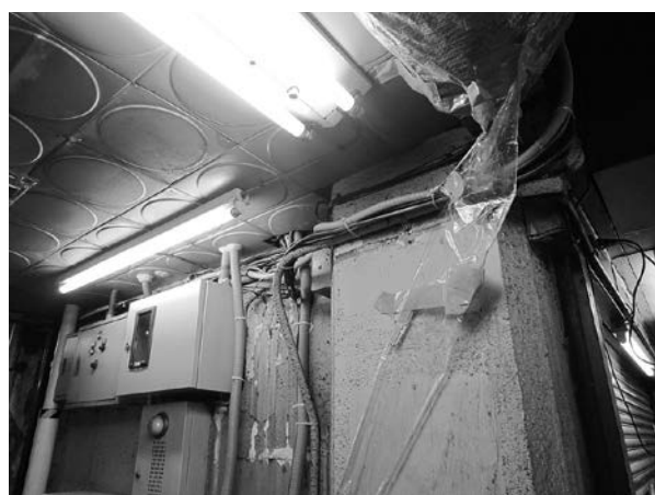
写真-2 老朽化した地下施設と漏水
