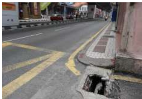
図 10 4 車線道路沿いの歩道（所々に深い穴）
