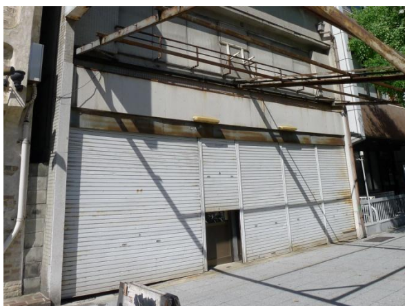
写真 3-10 シャッターの一部が空いている建物の例
