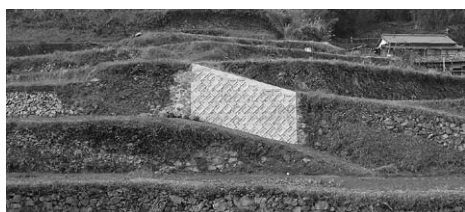
写真-2 石積みの一部に張られたブロック塀
