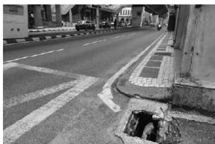
図5 4車線道路沿いの歩道（所々に深い穴）
