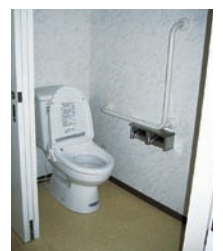
多目的トイレ
