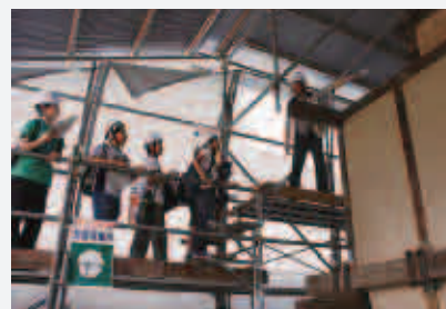
2012年度 だ が ね 遠 足 [足 助] 旧 鈴 木 家 住 宅 (2013年 重 要 文 化 財 指 定) 直 通 修 理 工 事 現 場
